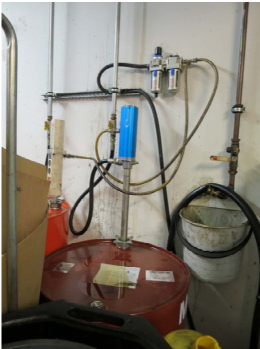
Kuva 10. Vuotava pumppu valuttaa voiteluöljyä tynnyrin kannelle. Tynnyrillä ei ollut suoja-allasta ja tilassa oli viemäri.
