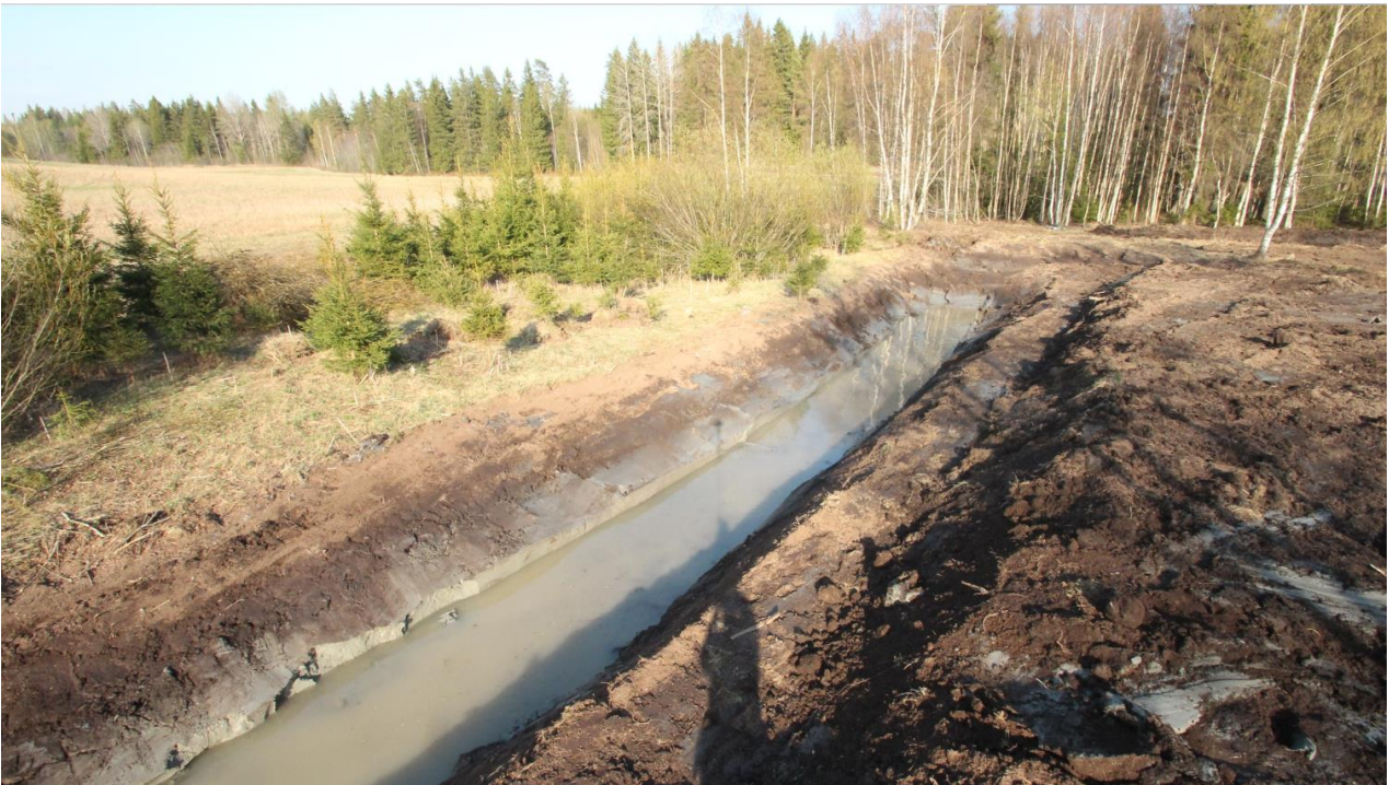
Laskeutussyväne, joka on 30 m pitkä ja 5-7 m leveä ja 1,5 m syvä. Kuva on otettu pian kaivutöiden jälkeen ja siihen on alkanut kertyä vettä, mutta ei ole vielä tavoitekorkeudessa. Syväne on kaivettu hieman kaarevaksi. Inkoon Gröndalsmossenin kosteikko 2019, Juha Siekkinen.
