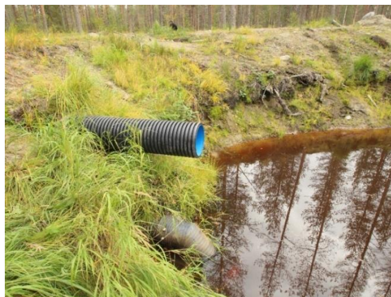
Putkipato metsätalouden vesiensuojelussa. Yläkuvassa putkipato on kuvassa olevan laskeutussyvänteen oikeassa reunassa ja alakuvassa se lähikuvassa. Alemmasta putkesta virtaa vesi ns. kesävesitilanteessa ja ylempi putki on tulvaputki. Molemmat mitoitetaan valuma-alueen laajuuden perusteella. Pudasjärvi, Juha Siekinen
