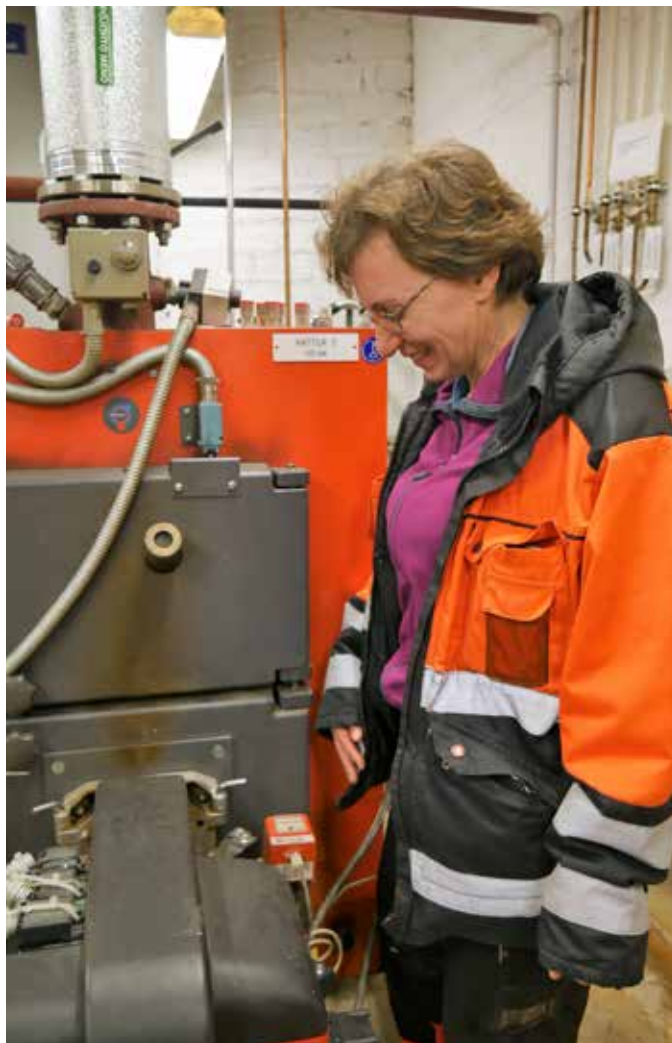
Kiinteistöhoitaja Tea Vaarala tarkkailee lämmitysöljyn kulutusta.
